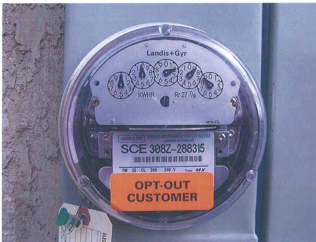
Edison Trojan Meter
